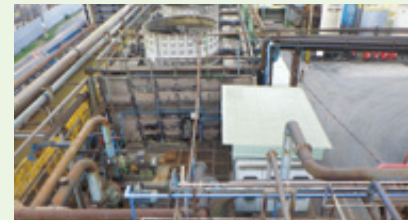
▲クローズドシステムの水処理設備
