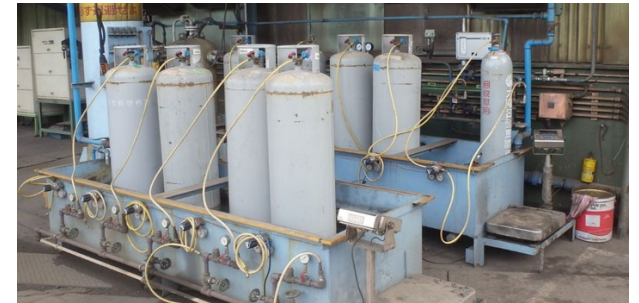
フロン処理設備
