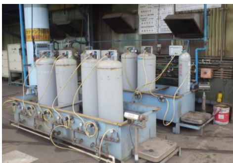
フロン処理設備
