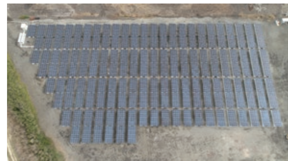
山口事業所に設置した太陽光発電設備
