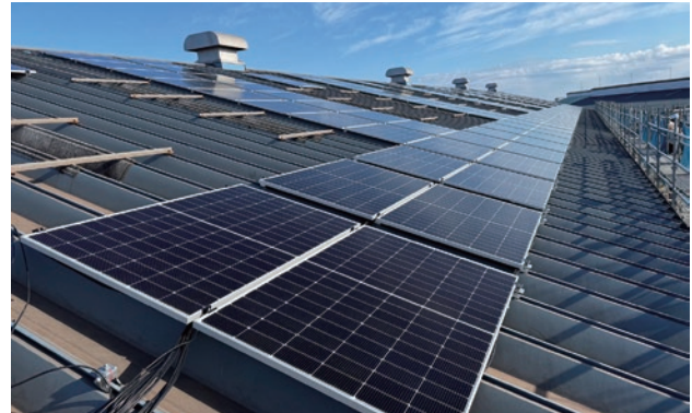
関東事業所新倉庫の太陽光発電設備
