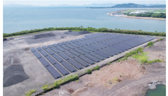
東沖太陽光発電設備
